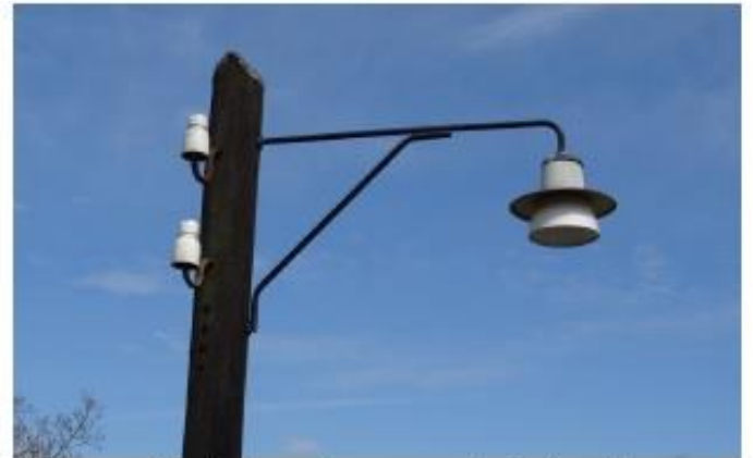
Massenweg 5. Hergebruik van oude in jaren 1970 afgedankte middenspanning elektriciteitspaal
